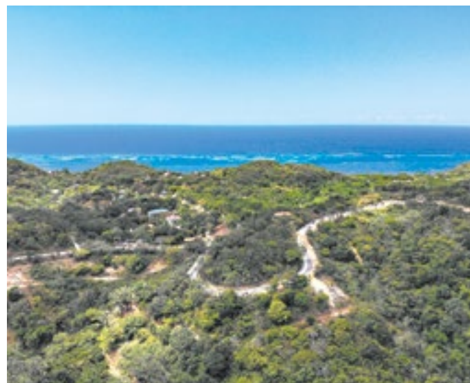
Con una inversión de L 218 millones de lempiras se construye el tramo carretero de 10.6 kilómetros en el municipio de José Santos Guardiola.
