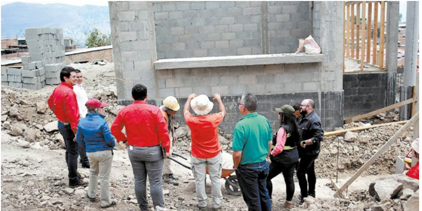
El complejo o cubo consta de tres edificios que albergarán laboratorios, biblioteca virtual, sala de capacitaciones, guardería, clínica, área de ambulancia, gimnasio.
