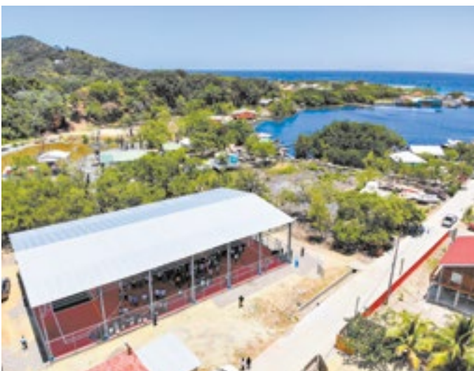
La construcción de la cancha número 52 tiene un costo de siete millones de lempiras en el municipio de José Santos Guardiola, Islas de la Bahía.
