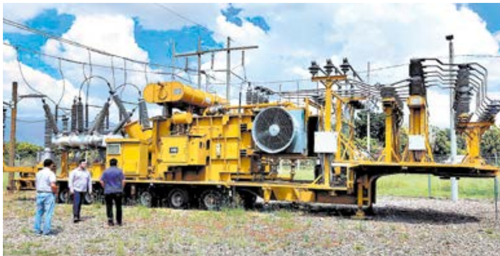
Subestación móvil que fue trasladada a la subestación El Estadio, San Pedro Sula, la cual permitirá brindar un servicio de electricidad más confiable a los abonados en el litoral atlántico.
