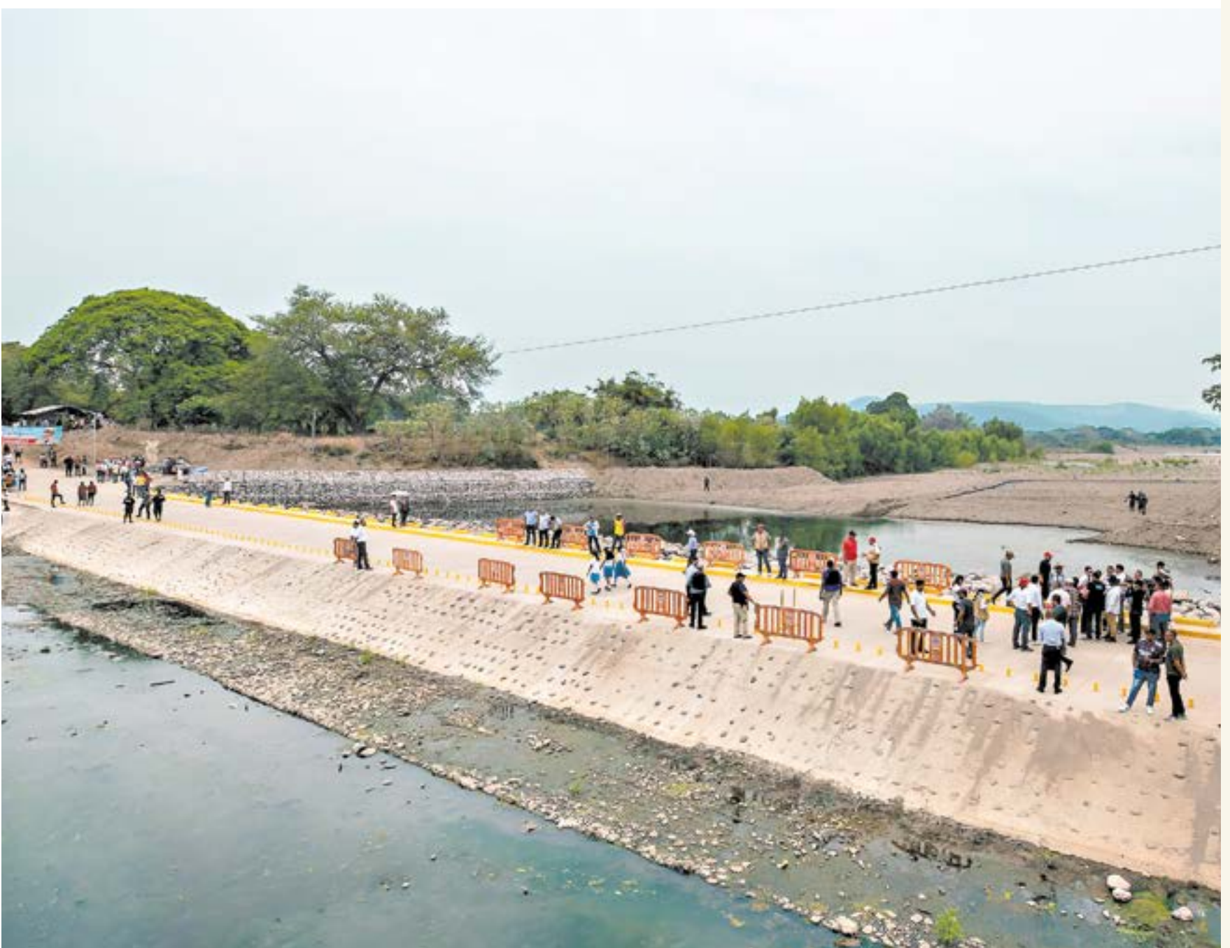
La obra de infraestructura tiene una longitud de 70.4 metros por 8.45 de ancho que vendrá a beneficiar a 16 comunidades de Alianza, Valle.
