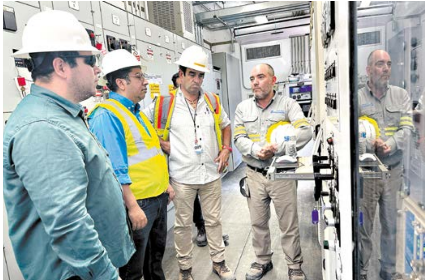
El ministro Erick Tejada junto a su equipo de trabajo supervisaron las pruebas a 180 MW de capacidad instalada (turbinas), que se inició integrando a partir de 1ra semana de abril 2024 y que se ampliará a 240 MW con gas natural licuado en el Valle de Sula.
